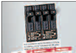
cortacircuitos seis interruptores de rama de 20 amperios proporcionan la protección para las cargas externas
